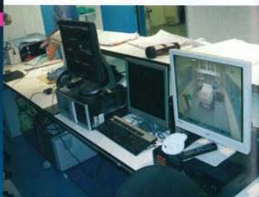
PUESTO DE CONTROL MONITORIZADO DE LA UCI
